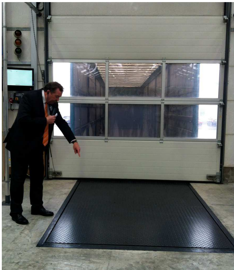
Рис. 3: Руководитель отдела сбыта промышленной отрасли Hörmann, Рюдигер Бирхенке (Rüdiger Bierhenke), показал гостям «вживую» на перегрузочной станции, как работает техника RFID, встроенная в перегрузочный мост.
